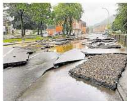
Die Straße in Vicht ist vor den Wassermassen massiv beschädigt worden. Asphaltstücke wurden heraufgeschwemmt.
