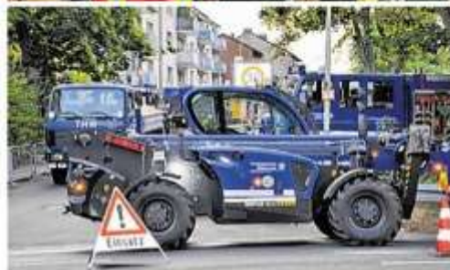
50 Helfer von Feuerwehr und THW rückten an, um die Fassade des Mehrfamilienhauses am Ostpreußenweg abzusichern. Das Technische Hilfswerk, das über ein spezielles Abstützensystem verfügt, baute ein Stützgerüst.
